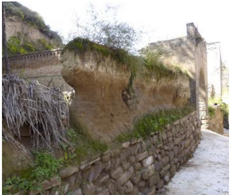
Erosion d'un mur en pisé
