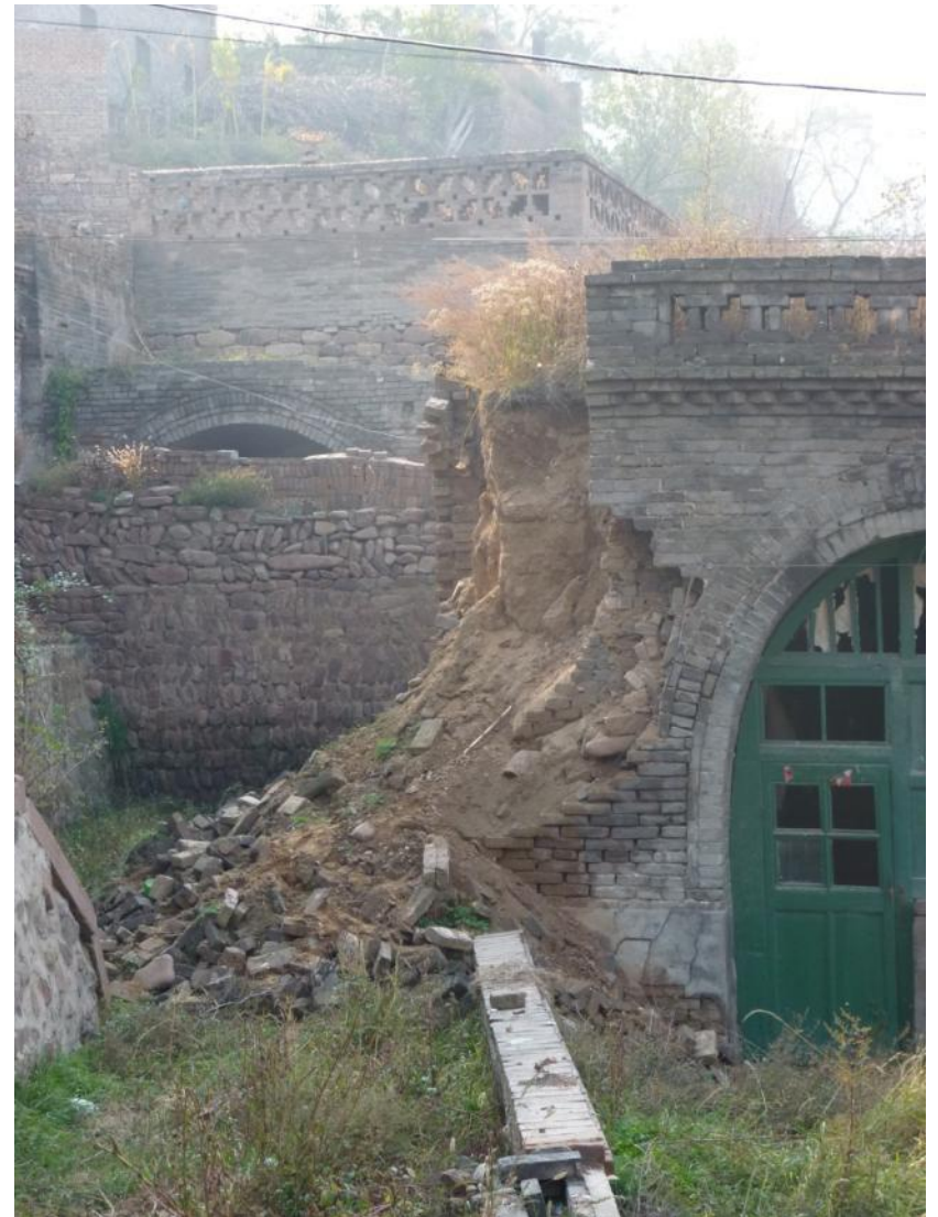
Effondrement d'une travée entière de yaodong dans l'école
