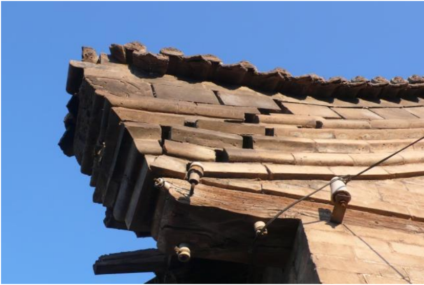
Dislocation de la maçonnerie en rive de toiture
