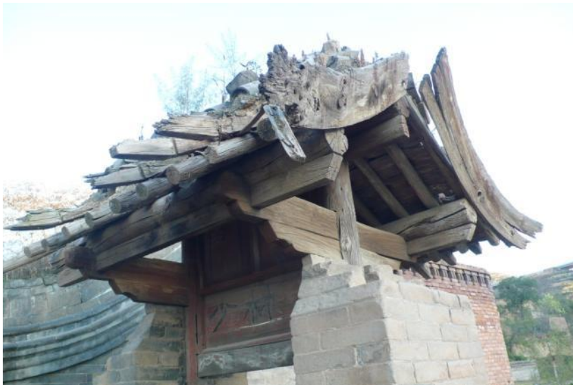
Désagrégation de la charpente du portail d'accès à la terrasse du temple
