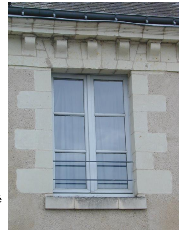
Fenêtre à grands carreaux, encadrement pierre de taille harpées, linteau segmenté inclus dans la corniche à modillons, appuis pierre de taille peu saillant, parement enduit, garde-corps constitué de deux fers horizontaux simples
